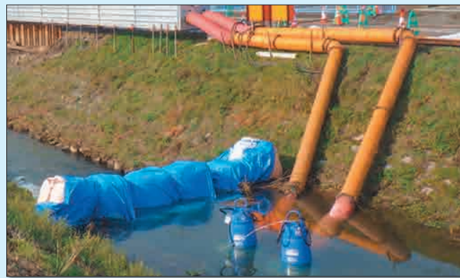
大容量水中ポンプ設置状況
