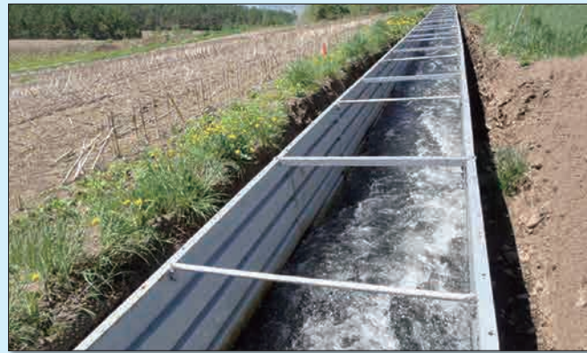
勾配をつけ流速を早めて大量に送水
